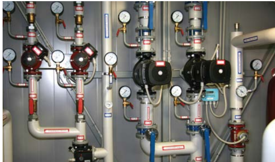
Mehr Kontrolle durch Erhöhung der Wasserzählerdichte. (Foto: Yury Maryunin/Fotolia.com)
